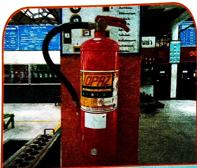
ภาพที่ 3.3 แสดงถังดับเพลิง
